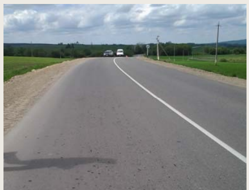
Состояние армированного покрытия через год
