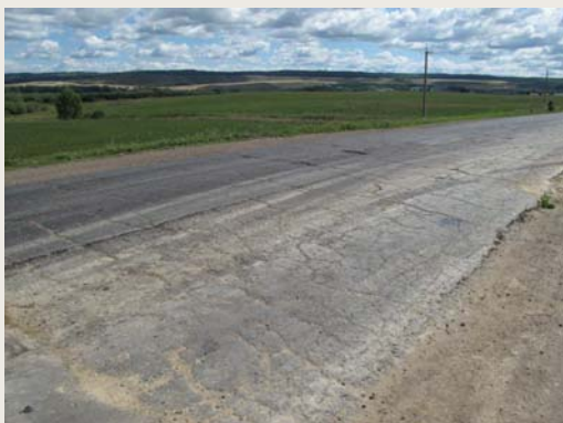
Состояние дорожного покрытия до ремонта
