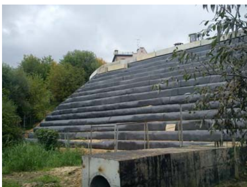
Сентябрь 2011г. Высота склона 7.5 м
