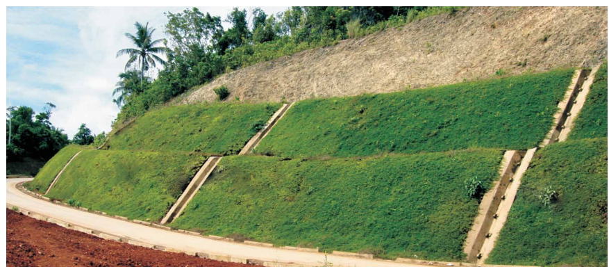
Penampakan lereng setelah 3 bulan
