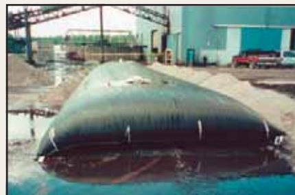
Desidratação de rejeito do processo de carvão utilizando a tecnologia Geotube®.
