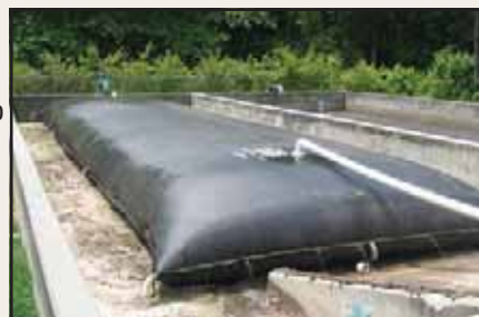
Unidade Geotube® em estação de tratamento de esgoto substituindo o leito de secagem.
