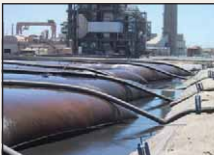
Unidades Geotube® em usina de geração de energia por combustível fóssil, desidratando cinzas em suspensão.
